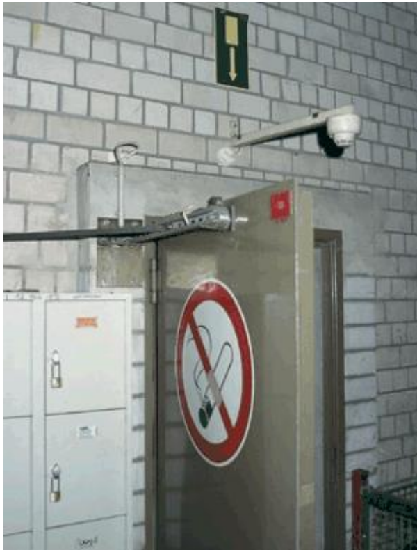
Bild 5: Brandschutztür mit zugelassener Feststelleinrichtung, die Auslösung erfolgt per Handtaster oder Rauchmelder
